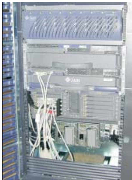
SunFire 3800: Fronttüre geöffnet sichtbar (von oben nach unten): RAID T3 Domain Controller CPU/Memory Board cPCI Interface Karten redundante Stromanschlüsse
